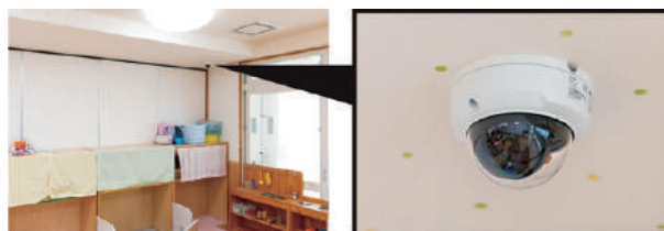
教室のコーナーの天井に設置された監視カメラ。ドーム型で目立ちにくいデザイン
