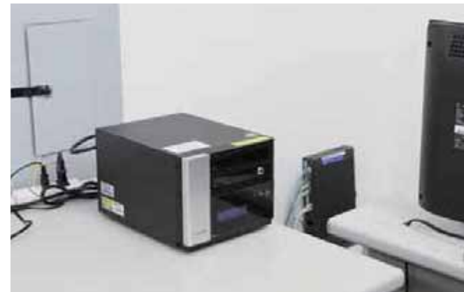
国内の土木現場事務所に1台ずつ設置されているWindows NAS。
