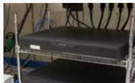
品質管理室に設置されているネットワークレコーダー。
