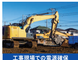
工事現場での電源確保
