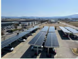
カーポート一体型太陽光発電設備 （テスコム電機 松本工場）
